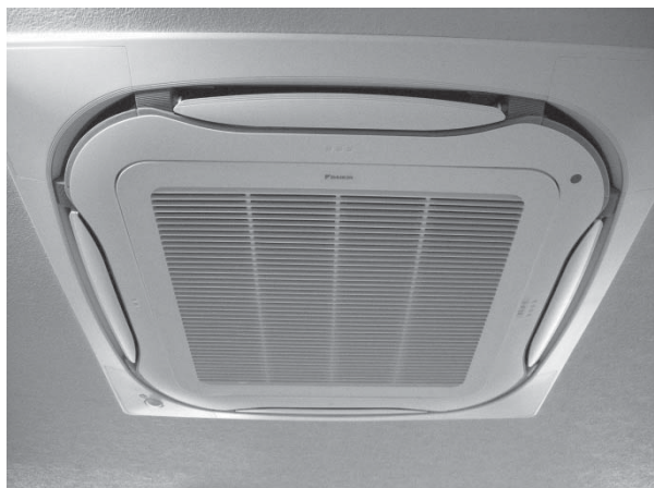
業務用エアコンの室内機は、天井埋込形では写真の
