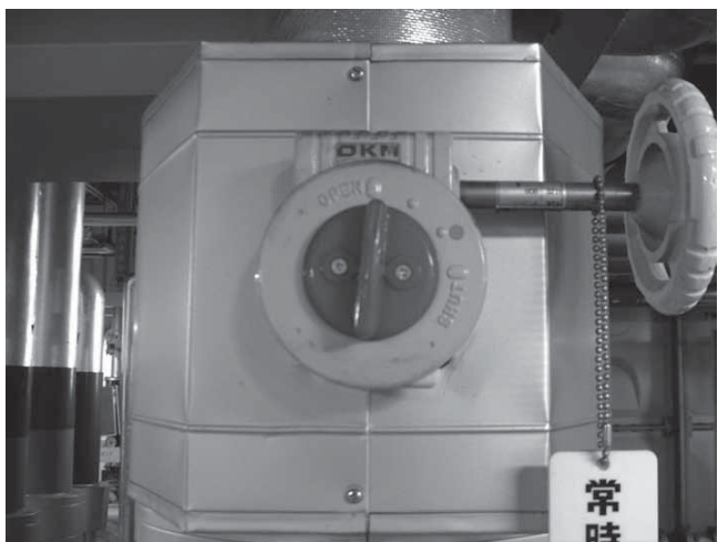
写真-3 二次ポンプ吐出バルブ
